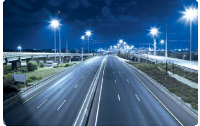
Hệ thống cáp ngầm trên đường cao tốc Underground cable system on highway
