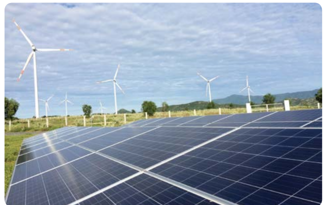
Hệ thống cáp ngầm tại các dự án điện mặt trời, năng lượng gió Underground cable system at Solar Energy Projects
